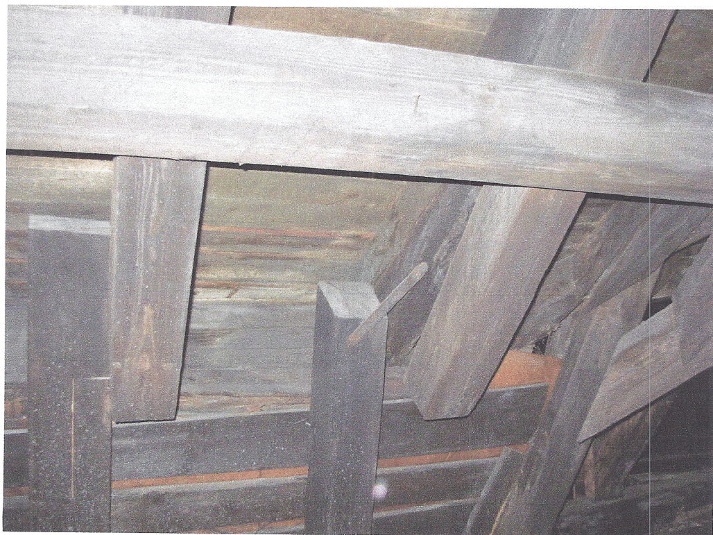
Niedoróbki w połączeniu górnej i dolnej części mansardy.
