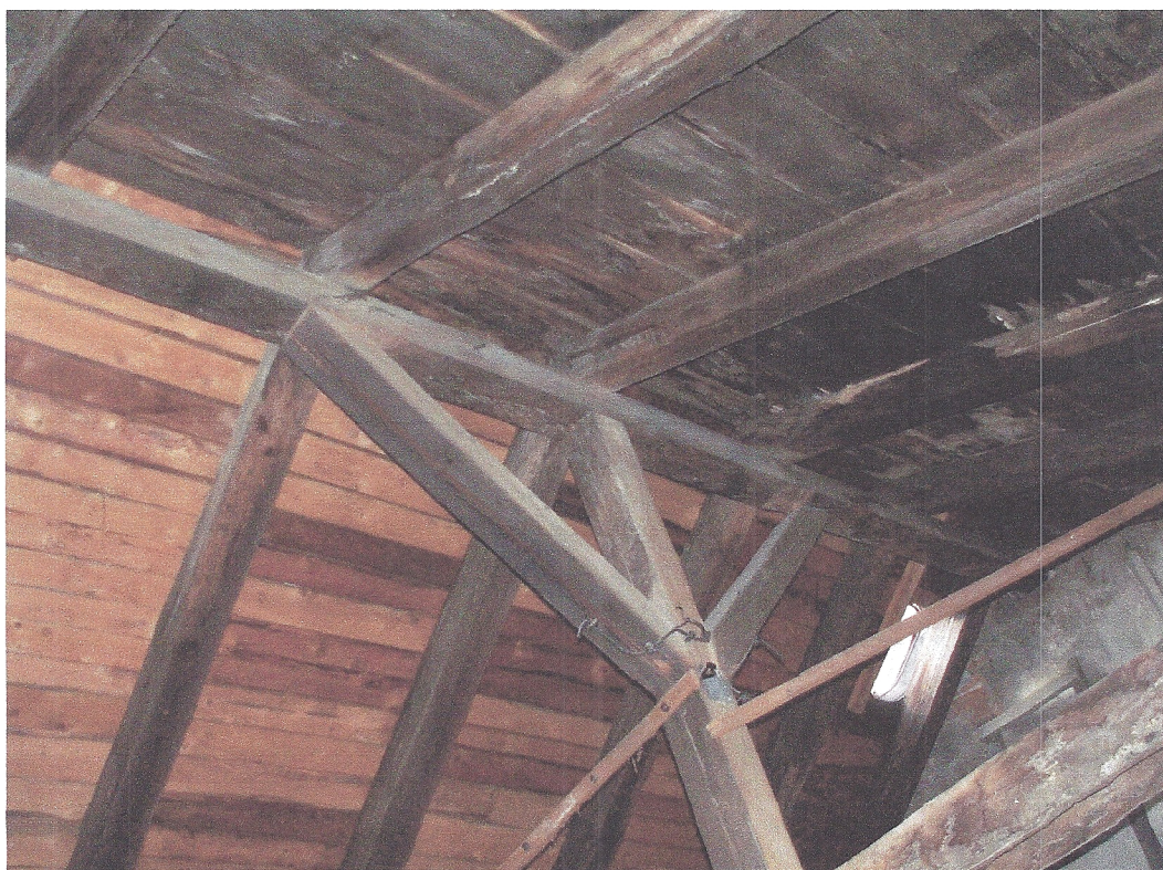
Widoczne ślady po zaciekach na deskowaniu.
