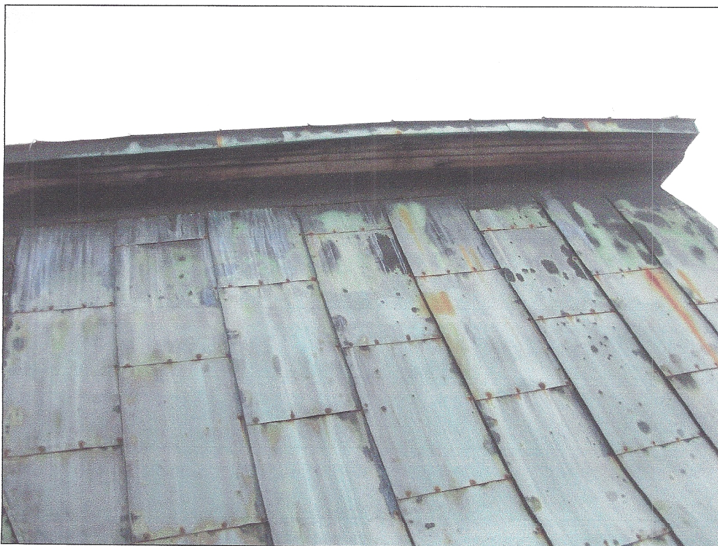
Okap górnej części mansardy (widoczne ogniska korozji galwanicznej)
