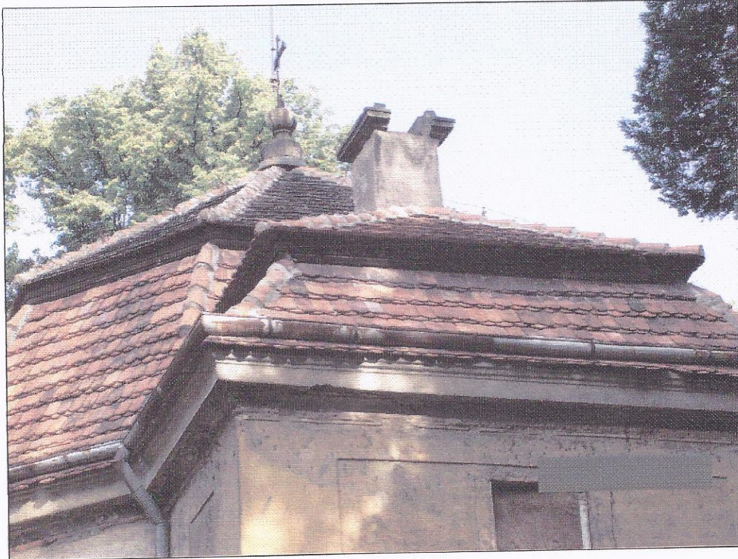
Szczegóły stanu technicznego pokrycia dachowego
