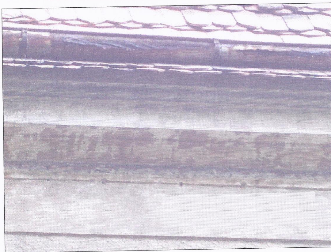
Szczegóły stanu technicznego pokrycia dachowego
