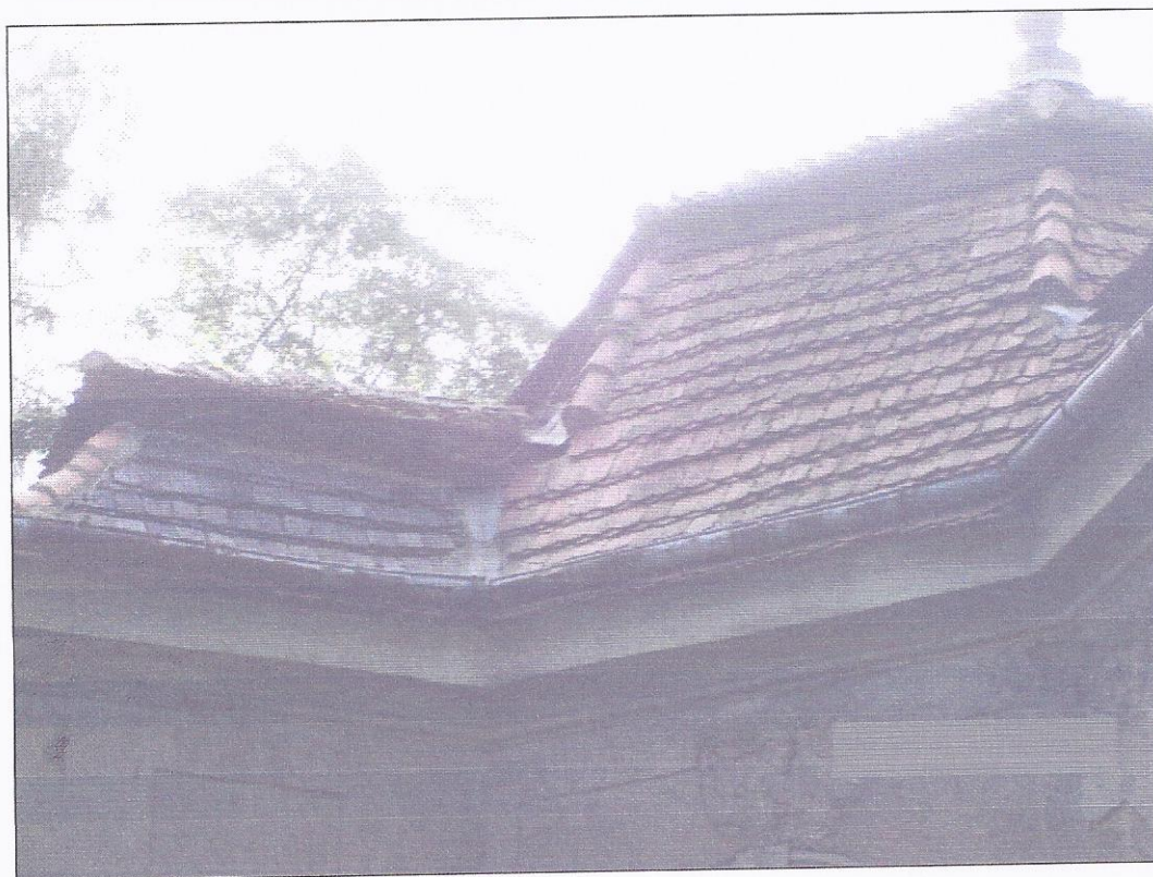
Szczegóły stanu technicznego pokrycia dachowego
