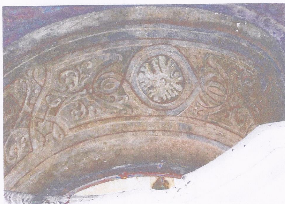
Fot. 4. Ujęcie górnej części glifu okiennego. Widoczna ornamentalna polichromia oraz zniszczenia gzymsu i fragmentów sztukaterii
