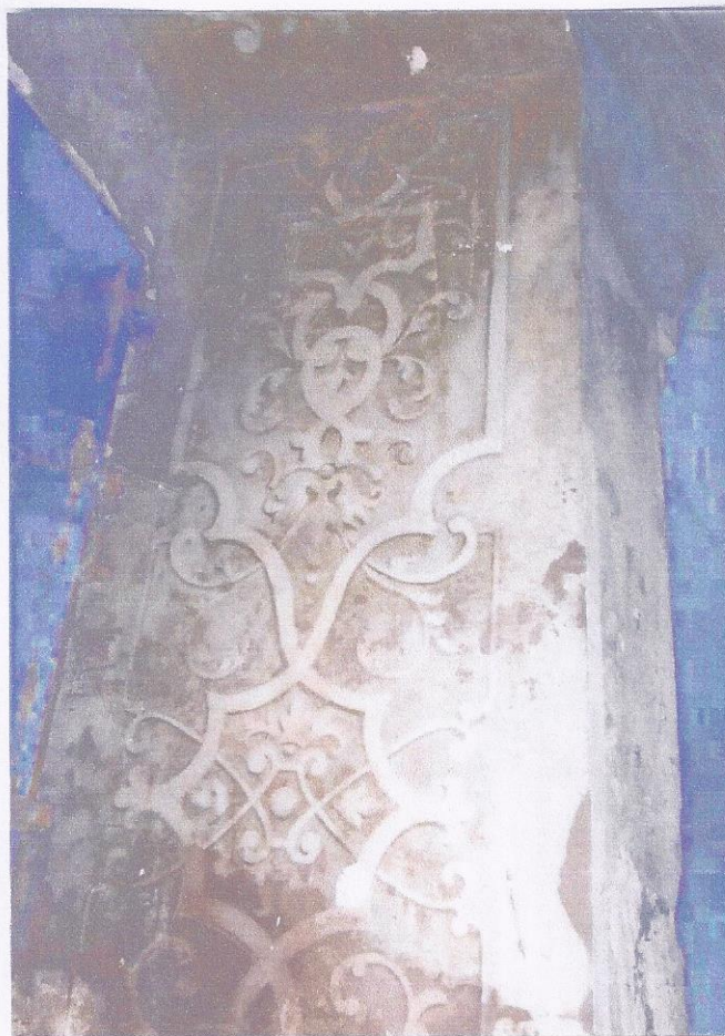
Fot. 13. Ujęcie glifu drzwiowego z polichromią z 1883 roku. Widoczne ubytki i przebarwienia powierzchni polichromii. Widoczne także oryginalne kute zawiasy drzwiowe.
