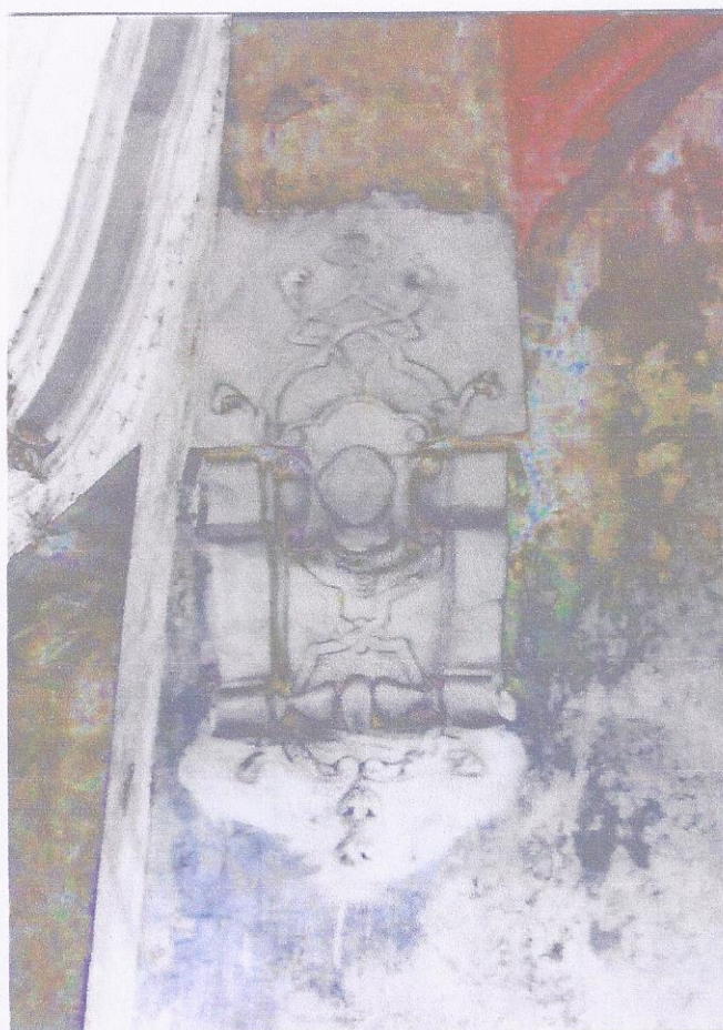
Fot. 16. Ujęcie wykonanego w masie sztukatorskiej wspornika. Widoczny stan jego zachowania oraz stan zachowania malatury ścian.
