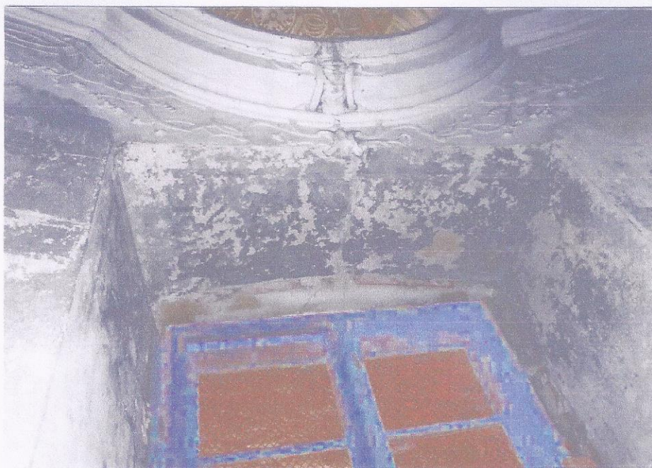
Fot. 15. Ujęcie górnej partii glifu okiennego z XIX-wieczną polichromią. Widoczne ubytki i złuszczenie warstwy malarskiej.
