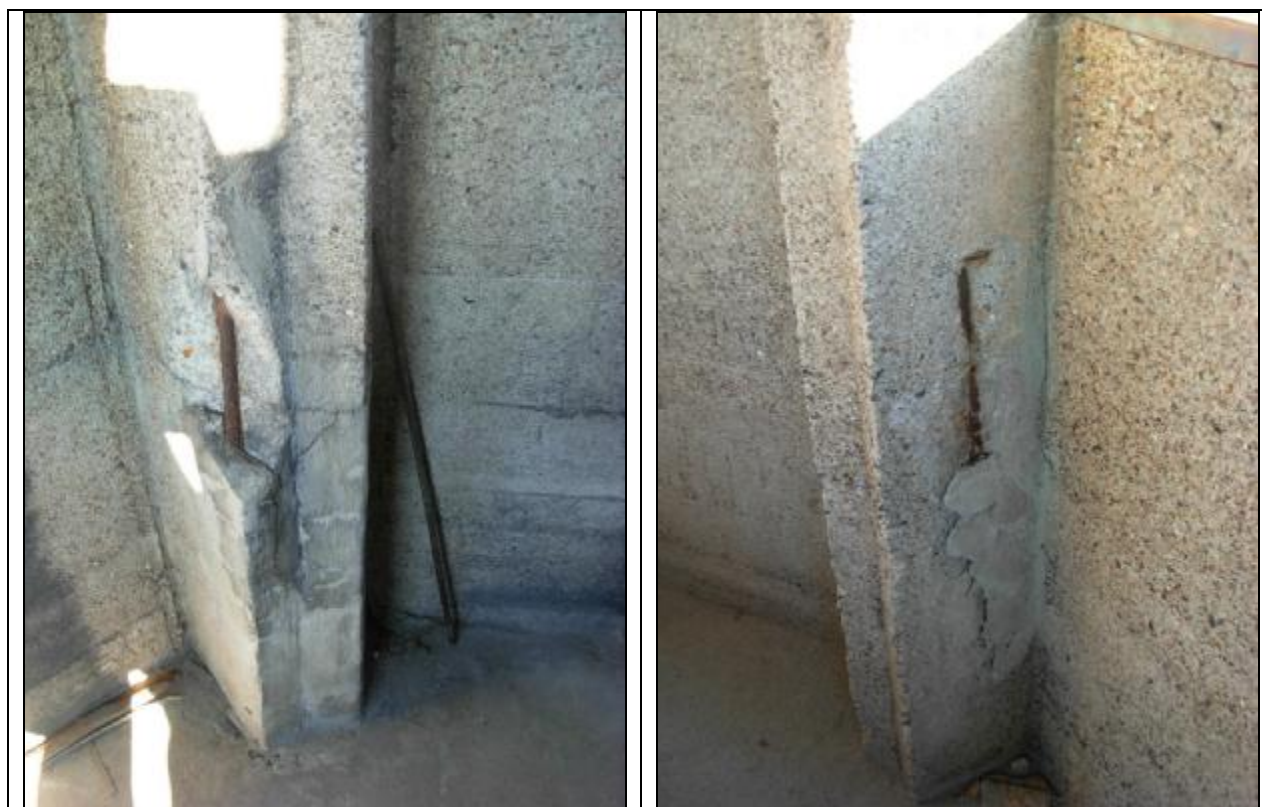
USZKODZENIA KONSTRUKCJI ŻELBETOWEJ TARASU WIDOKOWEGO WIEŻY
