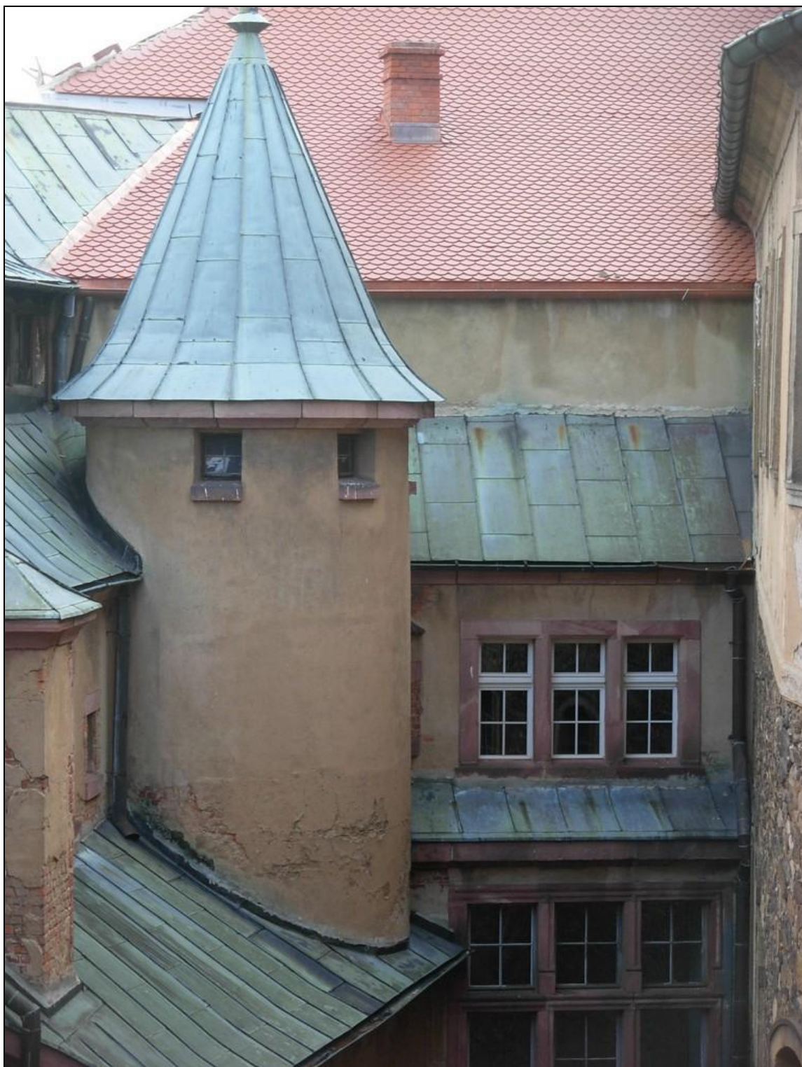
BASZTA WEWNĘTRZNA – WIDOCZNE USZKODZENIA TYNKU PRZEZ WILGOĆ
