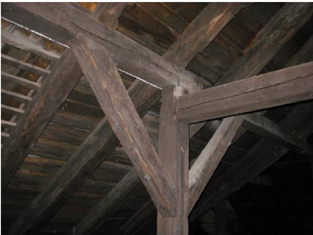
STAN ZACHOWANIA WIEŻBY DACHOWEJ
