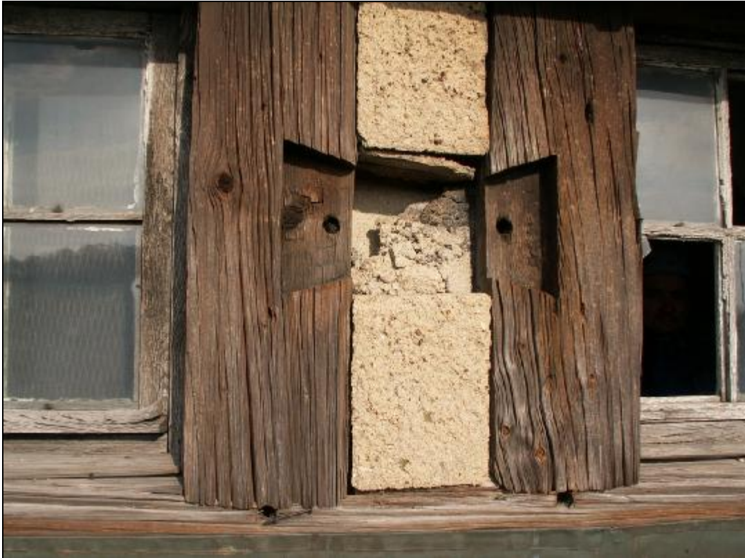
UBYTKI W KONSTRUKCJI ŚCIANY CZOŁOWEJ LUKARN
