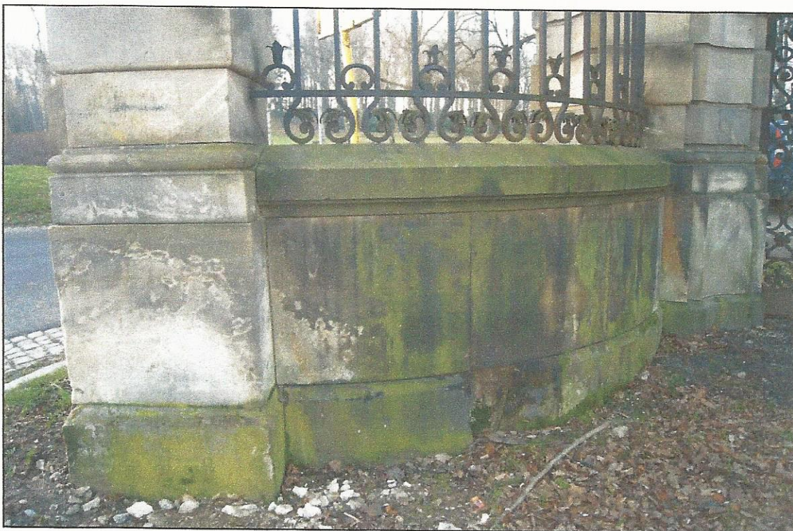
Fot.2 Stan przed konserwacją. Ujęcie postumentu pn-wsch. Widoczny stan zniszczeń.
