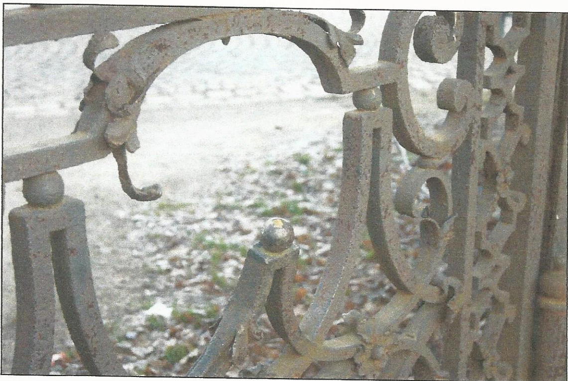
Fot.15 Ujęcie kwatery dolnej bramy. Widoczne wyłamania, ubytki i wygięcia ornamentów.
