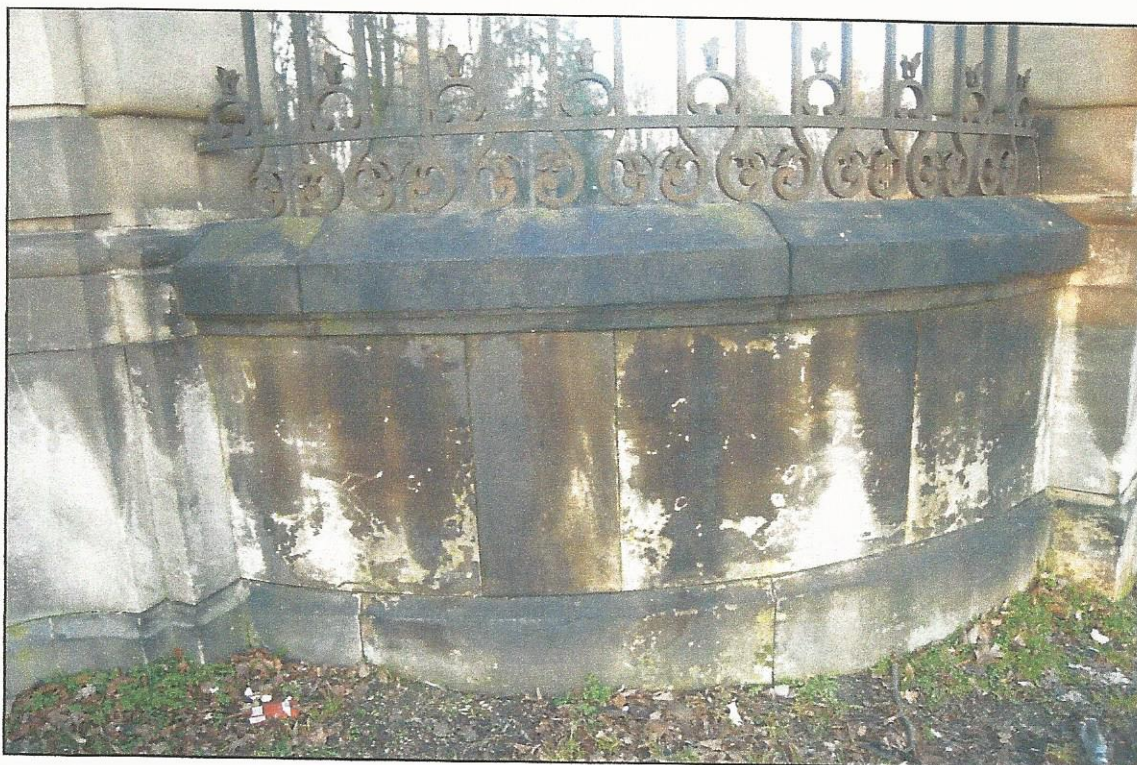
Fot.3 Stan zachowania postumentu pn. – zach. Widoczne zniszczenia.
