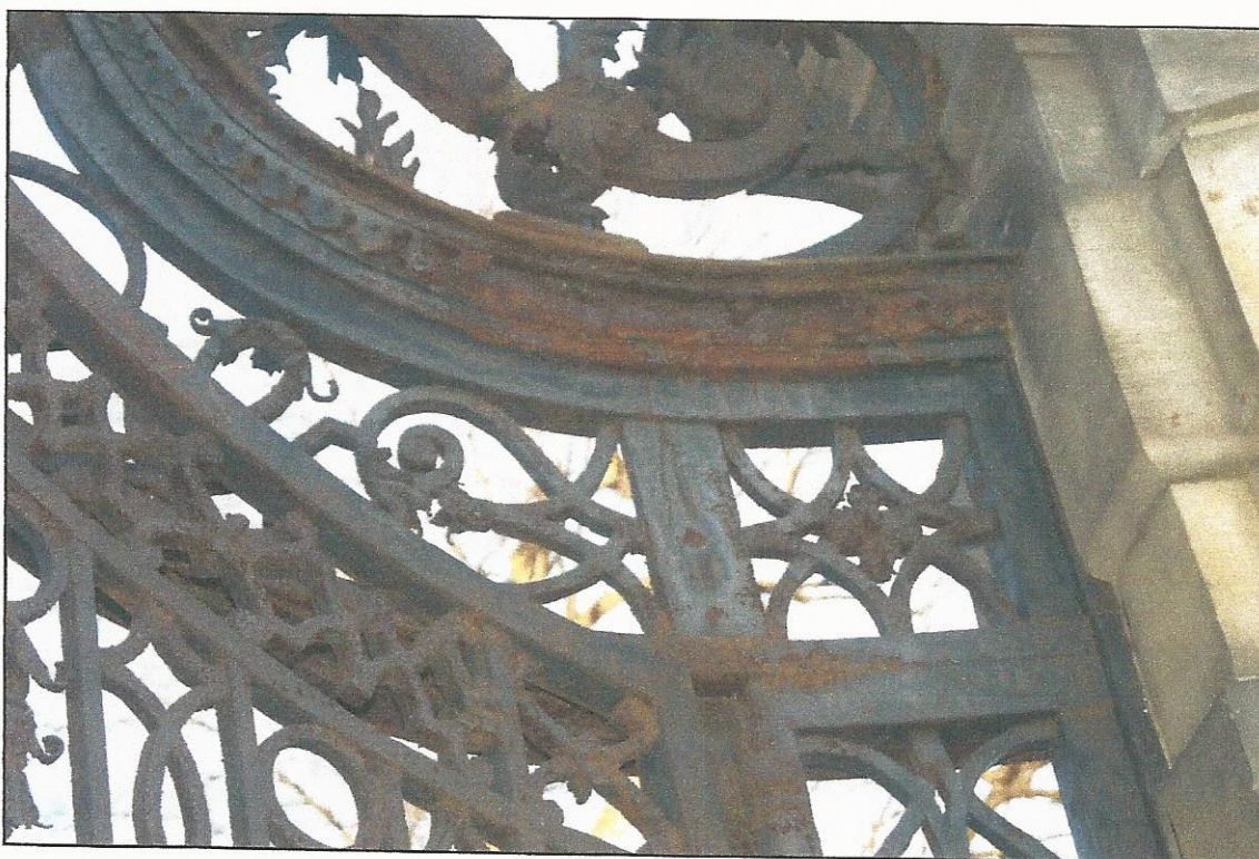
Fot.11 Stan przed konserwacją fragmentu pn-zach. Widoczne zniszczenia ornamentów bram
