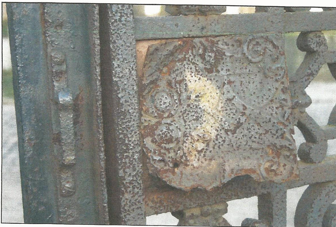
Fot.16 Widoczny szyld zamka z klamką z widocznymi zniszczeniami korozji.
