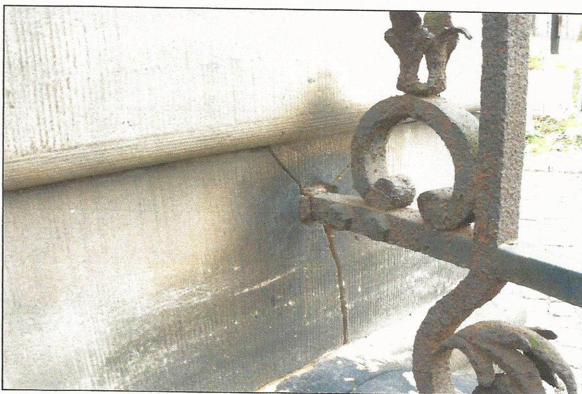
Fot.8 Ujęcie mocowania kraty z filarem. Widoczne zniszczenia i pęknięcia.
